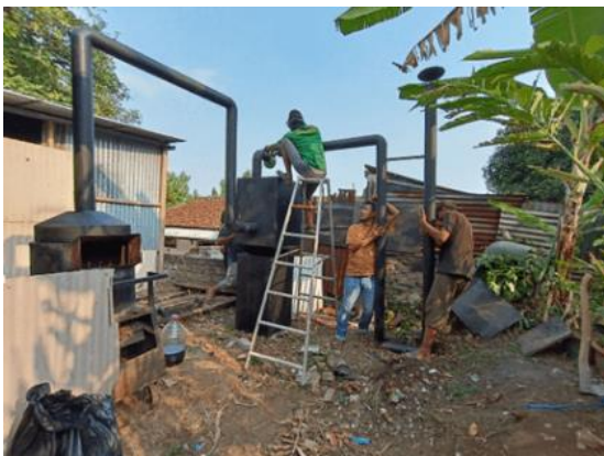
Gambar 3. Instalasi Sistem Filter di Lokasi Bank Sampah
